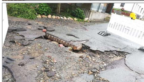
Das Regenereignis vom 13. Juli 2021: Der Ablauf des Teiches kann die Wassermassen nicht mehr fassen. Es kommt zu Schäden an der Straße, das Wasser hat aus der zu gering dimensionierten, zu flachen und desolaten Verrohrung herausgedrückt. Screenshot Video und Fotos: privat.
