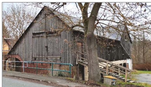
Die Gemeindescheune musste bereits wegen Baufälligkeit gesperrt werden.
