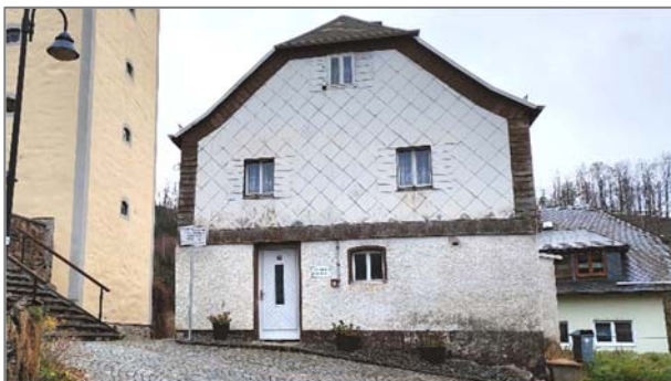
Giebel mit Eingang von Norden. An der rechten Traufseite ist ein neuer Sanitäranbau geplant.
